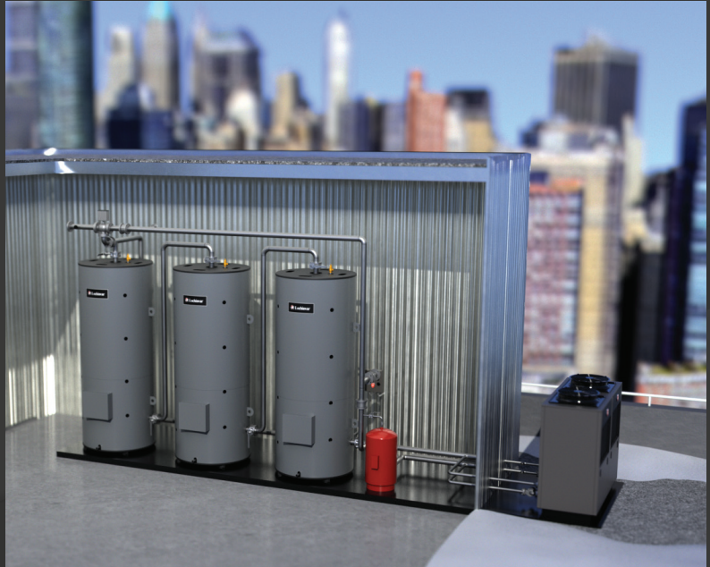
AHP 280 con tres tanques Thermal-Stor HP750G. Panel de control montado en la pared.
